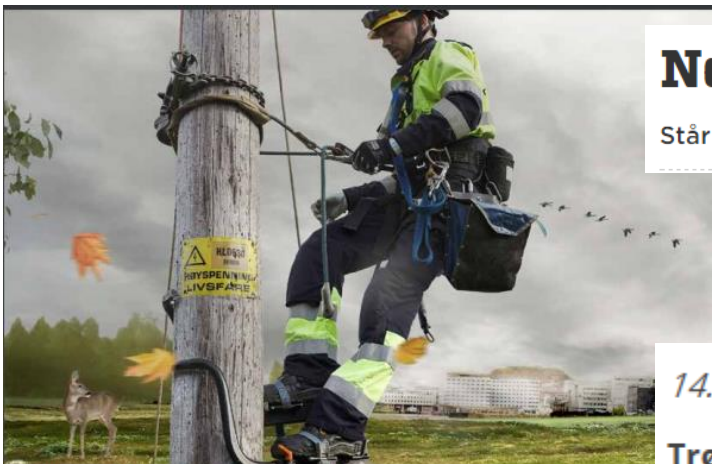
Elverk har behov for et drifts- og beredskapssamband og er interessert i Nødnett.
